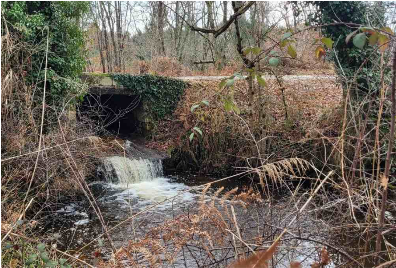
Louvrage DFCI qui devra être remplacé sur le ruisseau du Pas du Luc.
